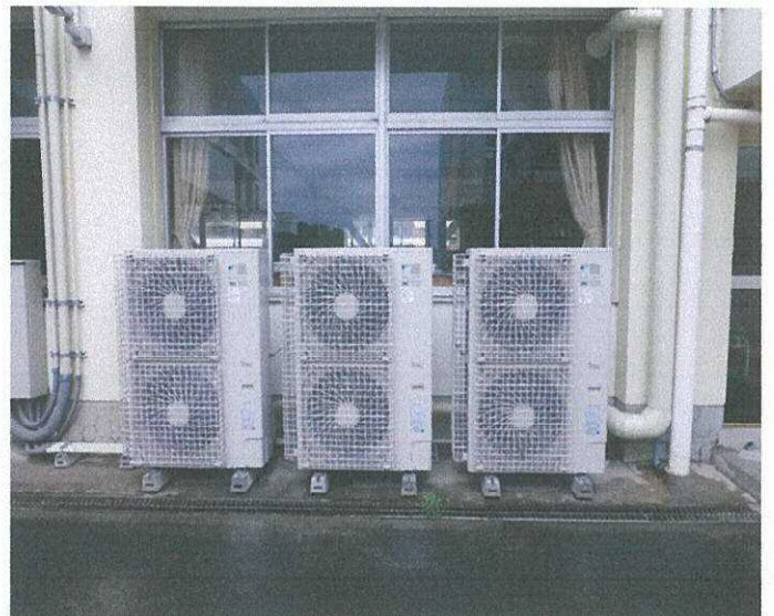
室外機/室外機は1/1
