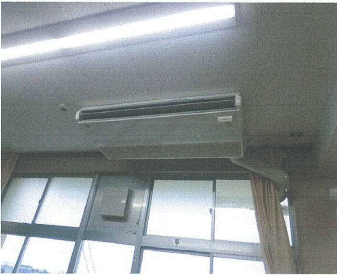
5馬力室内機と室内配管
