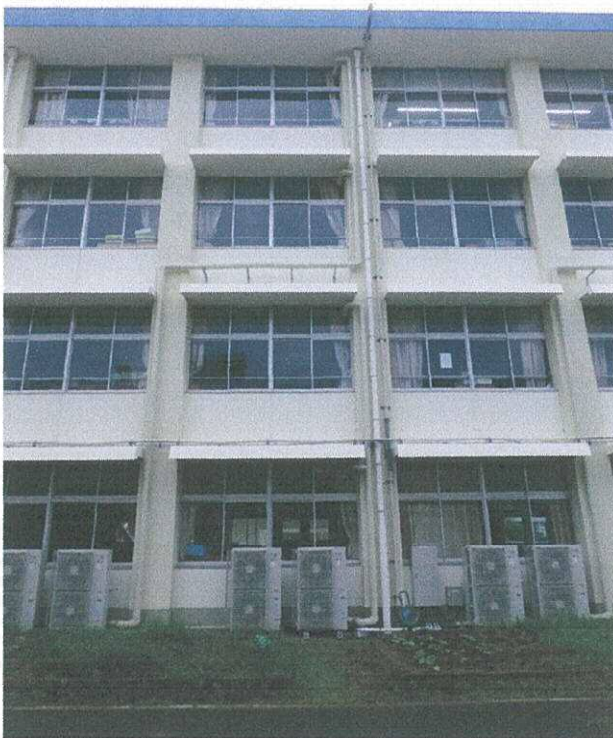
室外機と4階までの配管
