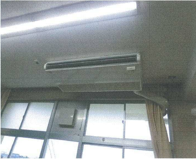
5馬力室内機と室内配管
