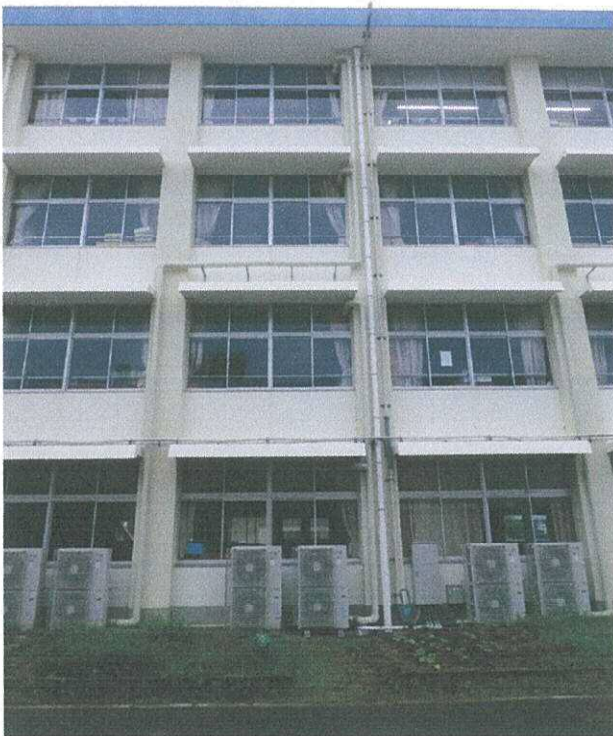
室外機と4階までの配管
