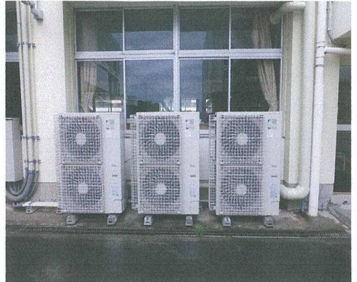
室外機/室外機は1/1
