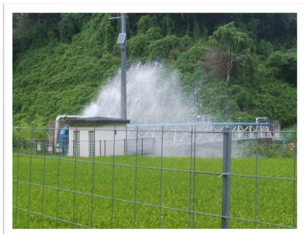
送水管漏水状況写真
