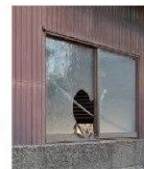
窓が割れた 管理不全空家
