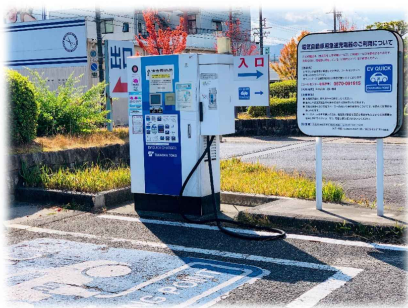
電気自動車急速充電器（市役所駐車場内）
