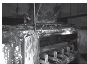
令和元年の火災事故で焼け焦げた設備
