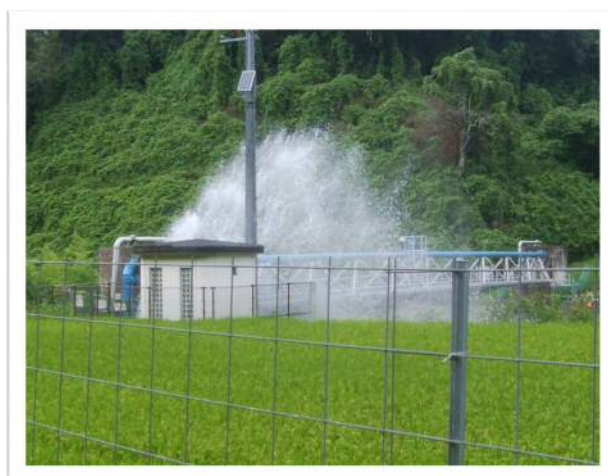
送水管漏水状況写真
