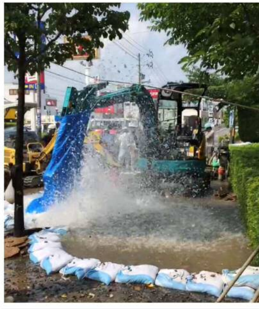
老朽化した管路の漏水
