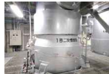
■二次燃焼室 溶融炉より発生する排ガスを完全燃焼します。
