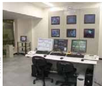
■中央操作室 施設全体の処理ラインを管理します。機器の状態や処理の状況をテレビモニタなどで監視し、安全で効率の良い運転を行います。
