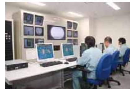
■中央制御室 施設全体の処理ラインを管理します。機器の状況や処理の状況をテレビモニタなどで監視し、安全で効率の良い運転を行います。
