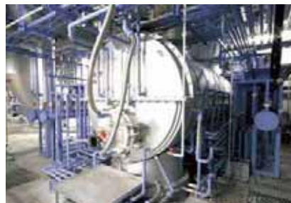
■溶融炉 流動床式ガス化炉によって発生した可燃性ガスとチャーを一気に高温で燃焼させます。焼却の際に発生する灰は溶かされ、冷却された後スラグとなり資源化されます。
