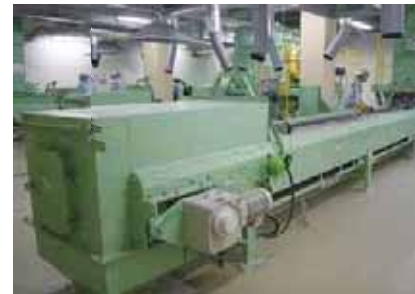
■びん手選別コンベヤ 手作業により異物を取り除きます。
