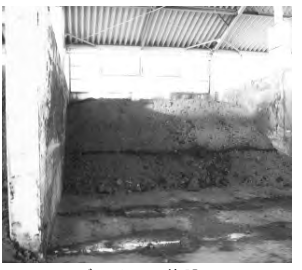
バイオマス施設
