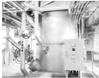
ガス化溶解炉
