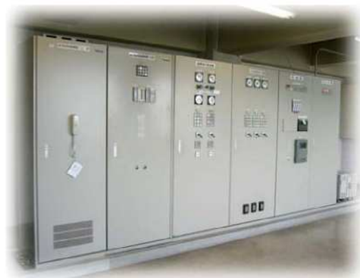
電気設備の状況
