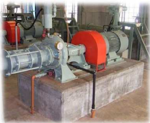
機械設備の状況
