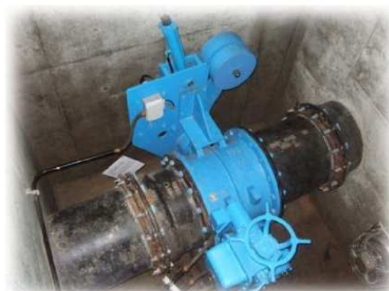
緊急遮断弁設置状況
