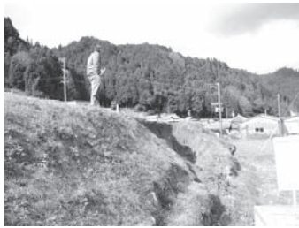
台風18号の被害
